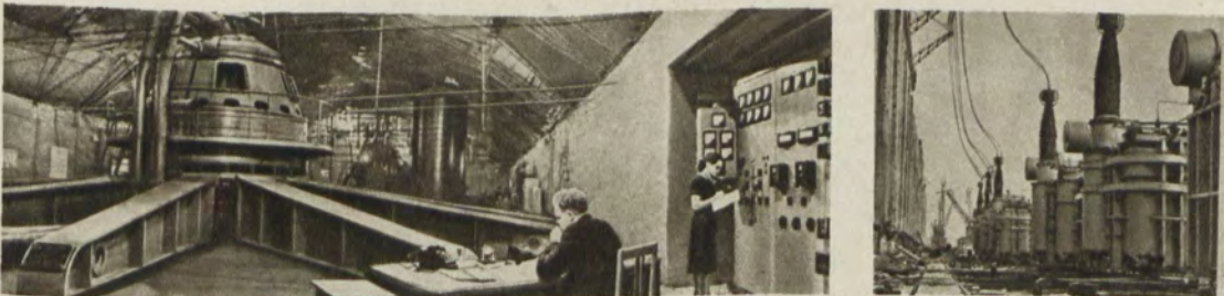
Слева — верхняя часть генератора (возбудитель) и щит управления, работающие во временном шатре; справа — трансформаторы, повышающие напряжение генераторов с 13,8 кВ на 400 кВ.
